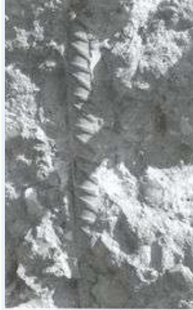
Estudio del agrietamiento por contracción plástica en el concreto sujeto a altos índices de evaporación.
