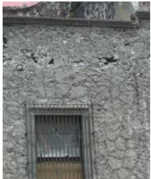
Degradación de la mampostería
