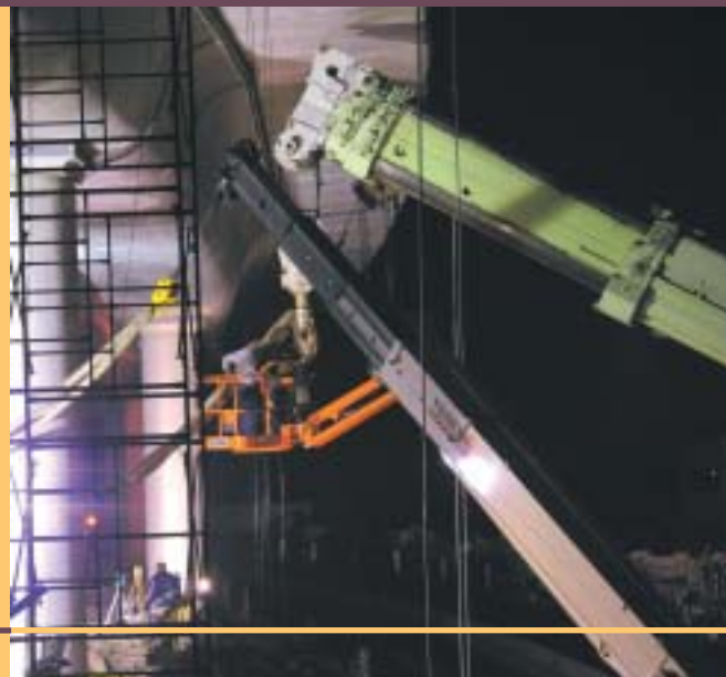
Maniobras para colocar las eslingas que se emplearon para jalar con una grúa el extremo superior de la columna
