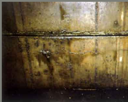
Fig. 2: Grietas horizontales que se originan típicamente en las terminaciones de los pernos de anclaje.
