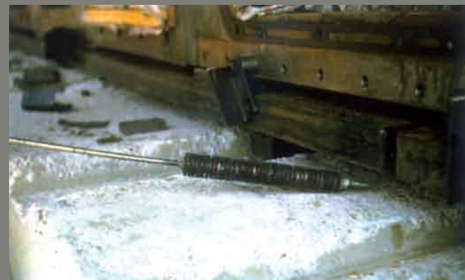
Fig. 1: Los rieles de acero y las calzas usadas para permitir el flujo de aire, reducen la distorsión del cigüeñal debido al calor capturado en la lechada epóxica.
