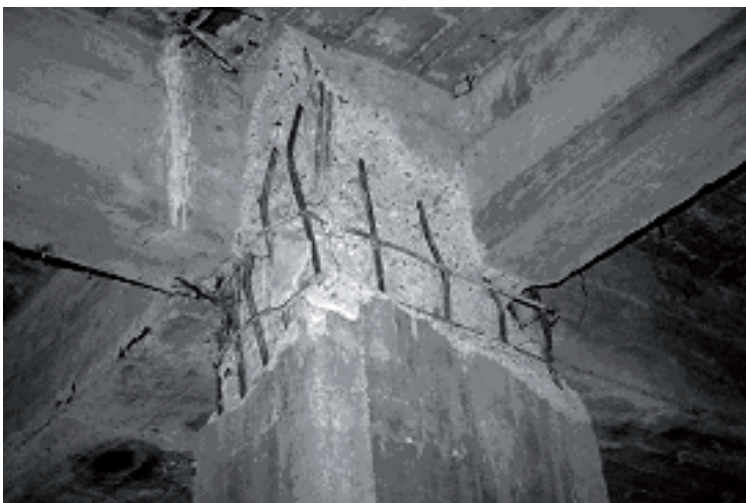
El buen comportamiento de una edificación bajo un sismo fuerte nace de la necesidad de garantizar la integridad de los nudos. Es común encontrar vigas más fuertes que columnas.
