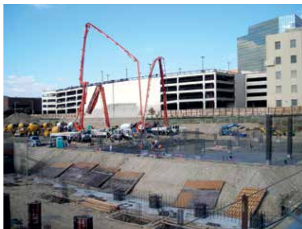
El bombeo dificulta obtener un buen nivel de acabado y encarece la solución.
