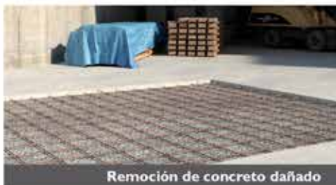
Piso de concreto dañado
