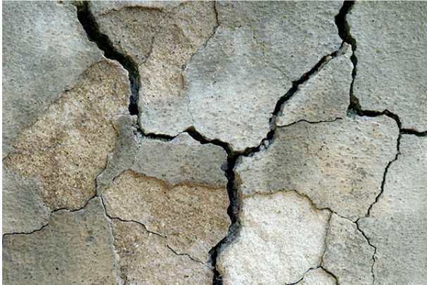
➤ Fisuras producidas por ciclos de hielo deshielo. Foto: © psrindustrialflooringltd.
