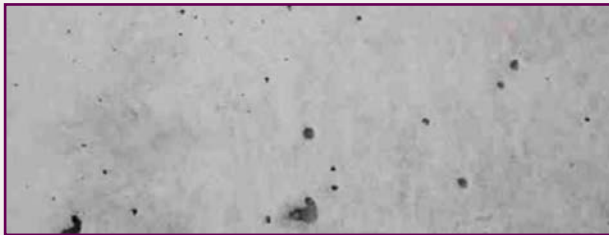
Figura 1: Burbujas en la superficie del concreto
