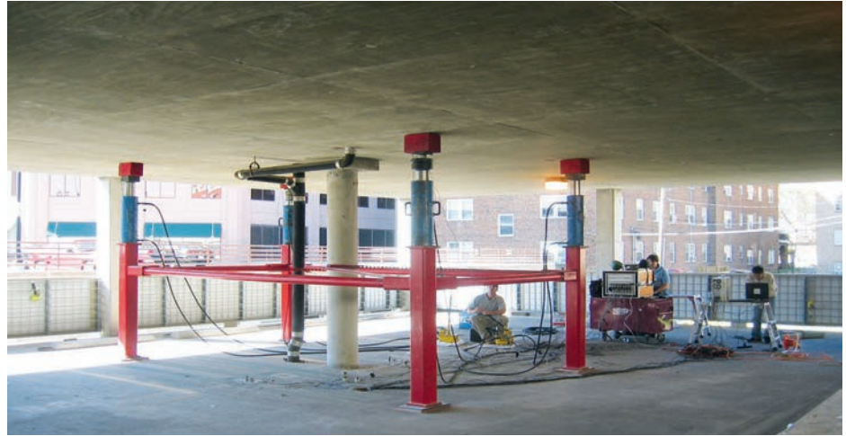
➤ Prueba de carga de una losa de concreto con gatos hidráulicos. Foto: Cortesía Simpson Gumpertz and Heger.
