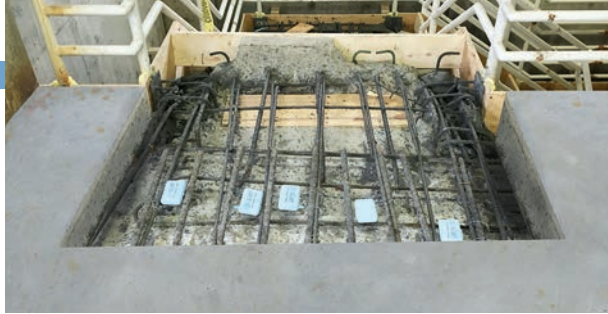
➤ Ánodos en la reparación de concreto deteriorado debido a corrosión del refuerzo. Foto: Cortesía Simpson Gumpertz and Heger
